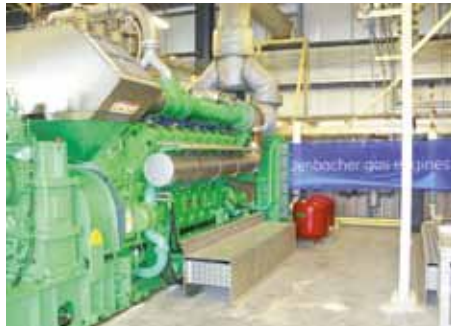
Das Deponiegasprojekt in Ox Mountain an der Half Moon Bay in San Mateo County (Kalifornien) versorgt rund 7.500 bis 10.000 Haushalte mit Strom.
