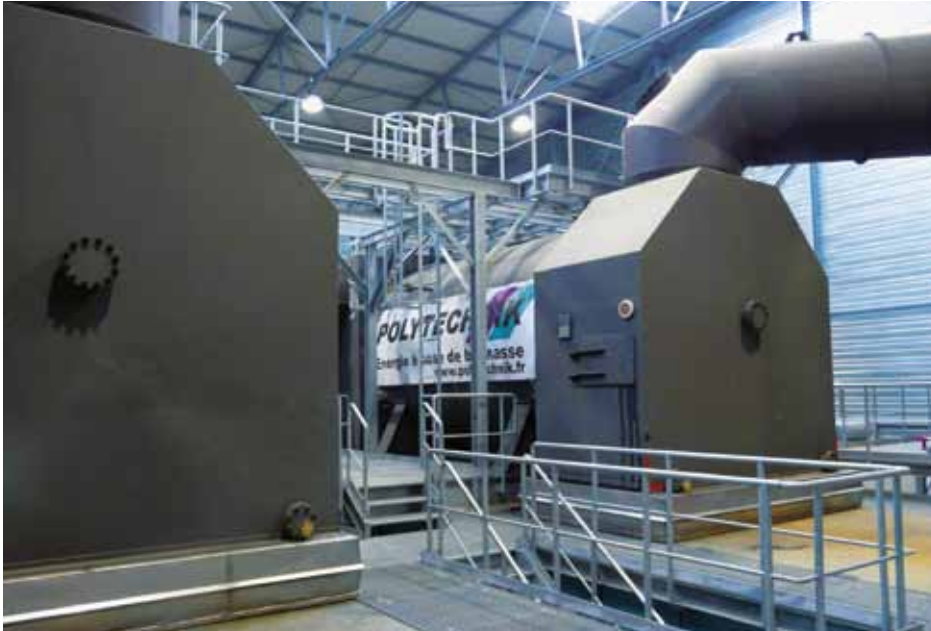
Abgas-Grenzwerte unterboten: Polytechnik liefert Biomasse-Kraftwerk nach Frankreich. The biomass power plant supplied by Polytechnik to a utility in France operates well below the emission limits.
