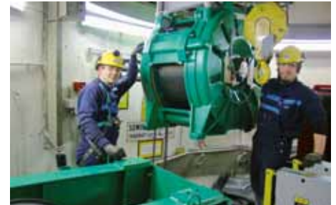
Der erste EcoDisc von KONE bei seinem Einbau im Donauturm auf rund 180 m Höhe
