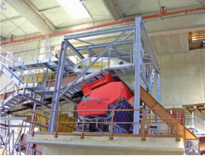
Aufbereitungs- und Transportanlage für Sekundär-Brennstoff (RDF) aus Haushalts- Restabfall in Wirbelschicht-Verbrennungs-anlage Equipment for treating and transporting refuse-derived fuel (RDF) in fluidized-bed incineration plant
