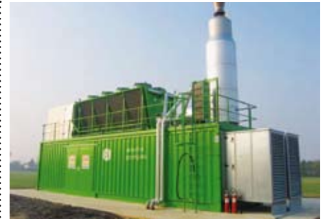
GE Energy lieferte für die Anlage ein Jenbacher Blockheizkraftwerk des Typs J320 GS GE Energy supplied a J320 GS Jenbacher block combination heat and power plant for the system
