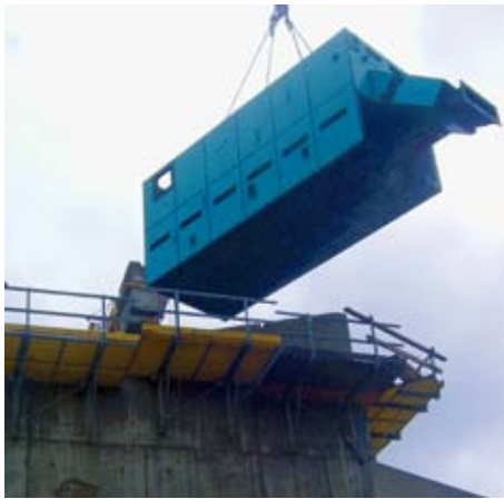
Einhub der Polytechnik-Feuerung Haul-in unit in a Polytechnik firing plant
