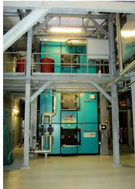
Die Polytechnik-Kesselanlage versorgt die Betriebsanlagen von Tirol Milch mit Raum- und Prozesswärme The Polytechnik boiler system supplies room and process heat for the operating plants of Tirol Milch
