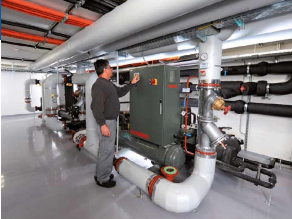
Großwärmepumpe von Ochsner bei der Energie AG in Linz Large scale heat pumps from Ochsner at Energie AG in Linz
