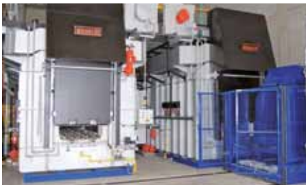
Die gesamte Linie, die im SEW Werk Bruchsal installiert wird, besteht aus insgesamt 4 Aichelin-Doppel-Durchlaufkammeröfen The entire line installed at the SEW factory in Bruchsal consists of a total of four Aichelin continuous-feed twin chamber furnaces
