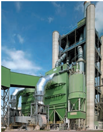
Planta de eliminación de polvo para molino de cemento
