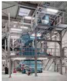
Polytechnik公司的 PolyGasification装置 Polytechnik, PolyGasification Plant
