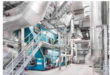
PolyCarbonisation装置 PolyCombustion plant
