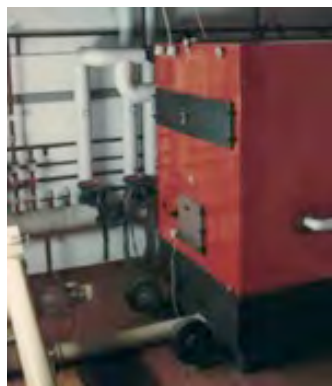
最初のボイラー 1965年
