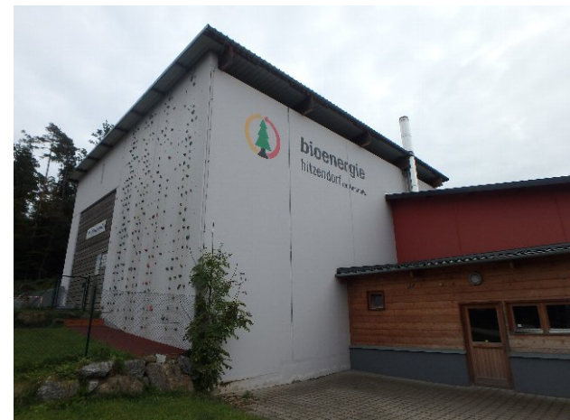
木質バイオマスボイラー
