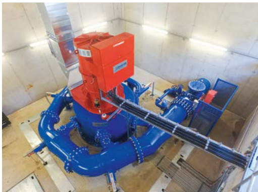
Pelton Turbine HPP Hintergössgraben
