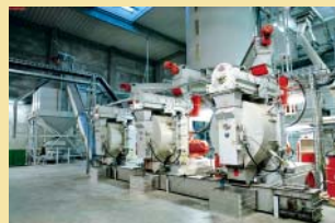
Wood pelleting plant with three presses (total output 12 tons/h). Holzpelletieranlage mit drei Pressen (Gesamtleistung 12 to/h).
